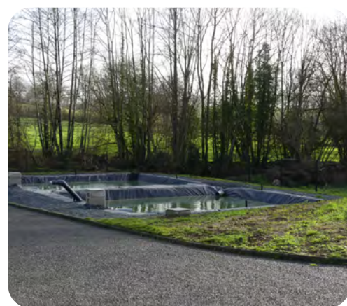
Deux lagunes permettent désormais de tamponner les eaux de lavage avant leur rejet au milieu naturel.
