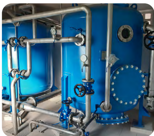
Afin de reminéraliser l'eau, deux nouveaux filtres à calcaire terrestre ont été installés.
